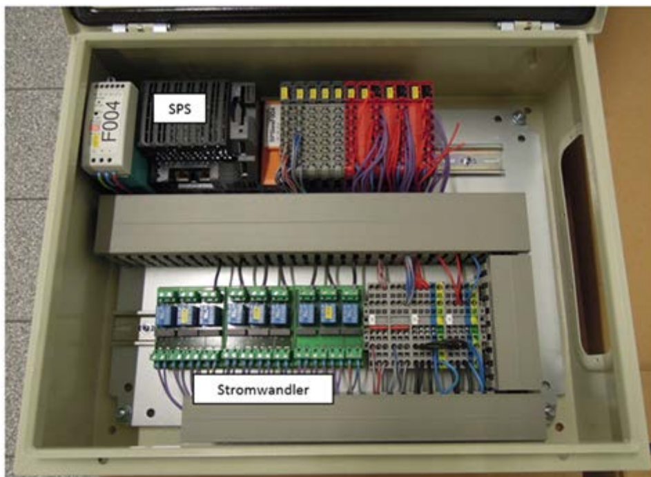
Abbildung 15: Schaltschrank der Messanlage F004_2017_SW
