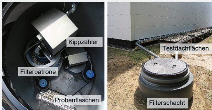
Fig. 3 Pilotfilter zur Regenwasserbehandlung am Standort Berlin. Links: Blick in den geöffneten Schacht, rechts: Aussenansicht des Schachtes mit angeschlossenen Flächen.
