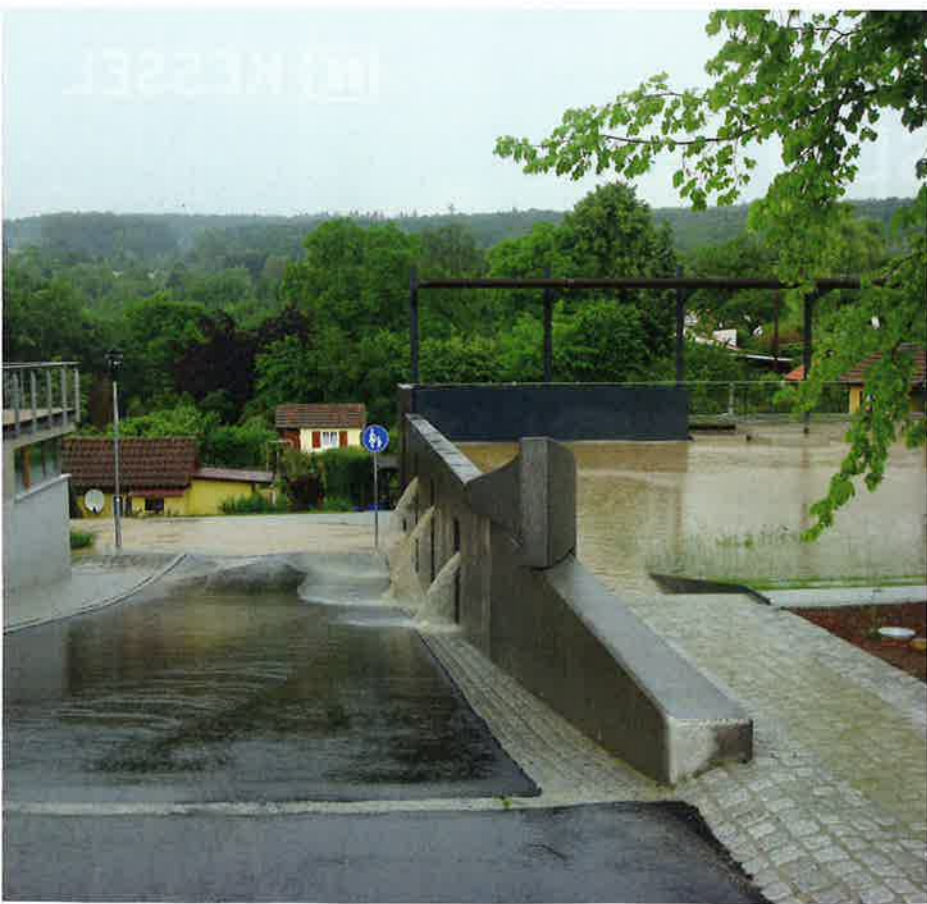
Anstatt eines Abflusses in die Kanalisation wird das natürliche Gefälle genutzt.
