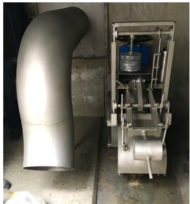
Abb. 80: Rechts die Abflussdrossel und links der Notüberlauf des Retentionsteils
