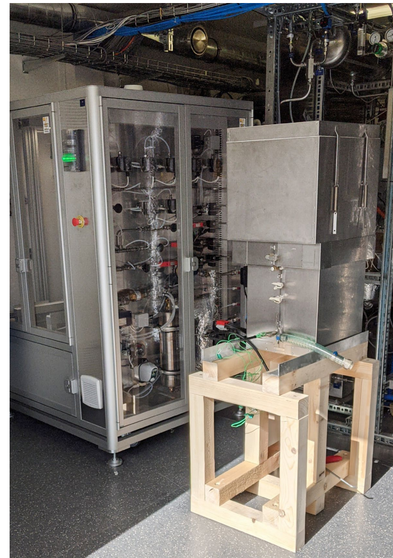
Installation des Zellstapels an der Hochtemperaturolektrolyse
