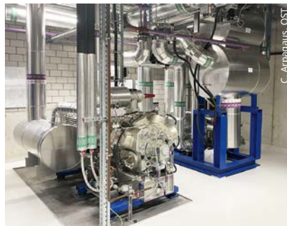
Beispiel einer industriellen Wärmepumpe in der Energiezentrale eines Schweizer Unternehmens.
