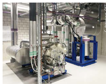
Exemple d'une pompe à chaleur industrielle dans la centrale énergétique d'une entreprise suisse.
