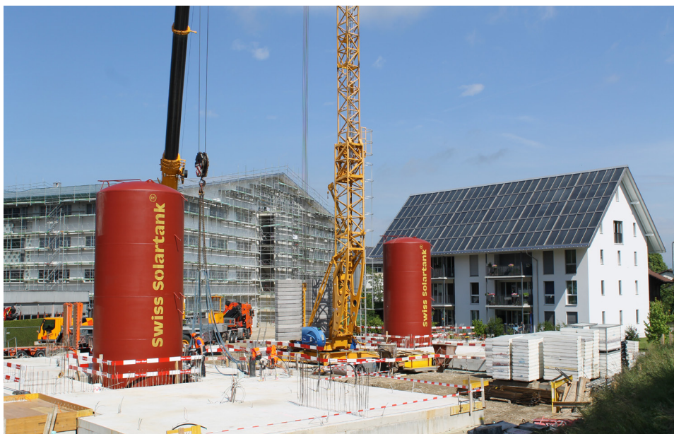
Bild 1: Wärmespeicher für die erste Generation 100% solar beheizter MFH in Oberburg. Quelle: Jenni Energietechnik AG
