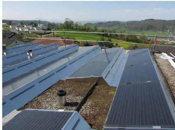
Abbildung 25: Dachansicht der PVT-Anlage auf dem EFH in Wettswil.
