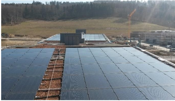
Abbildung 27: PVT Kollektorfelder auf Gebäude C
