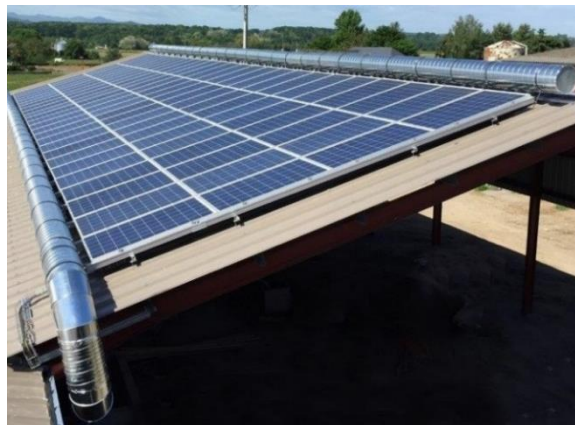
Abbildung 24: Luft PVT-Anlage zur Heutrocknung in der französischen Provinz Béarn. Produkt Cogen'air der Firma BASE. (Quelle: BASE Innovation)
