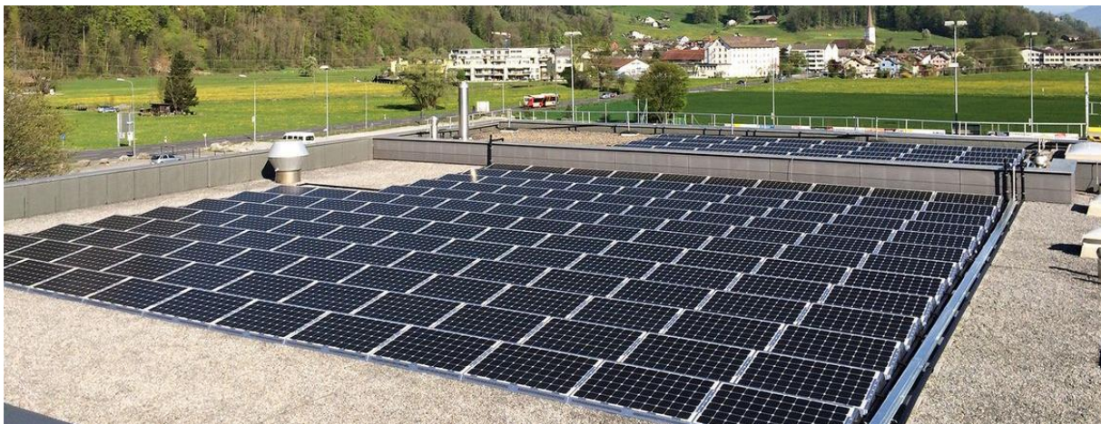
Abbildung 37: PVT-Anlage von 292 m 2 auf dem Dach der linth-arena. Quelle: ZHAW Wädenswil.
