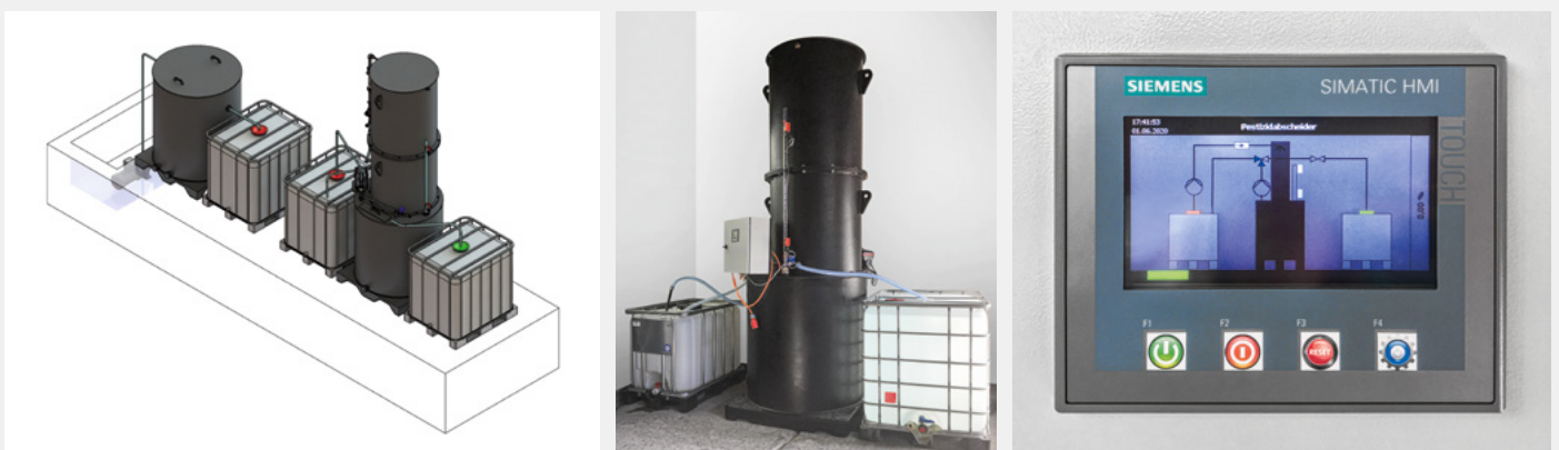
Fig. 5 Technische Behandlungsanlage für Waschwässer in der Landwirtschaft. Links: Anlagenkonfiguration mit GUS- und PSM-Modul; Mitte: PSM-Modul mit GAK-Säule für Waschwasseranfall bis 50 m³ pro Jahr; rechts: benutzerfreundliche Steuerung mittels Touch-Panel (Siemens Simatic).
