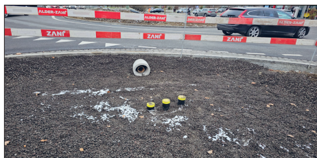
Zulauf für Strassenabwasser und Beprobungen für Sickerwasser am Standort mit Pflanzsubstrat, bevor die Bepflanzung erfolgte.
