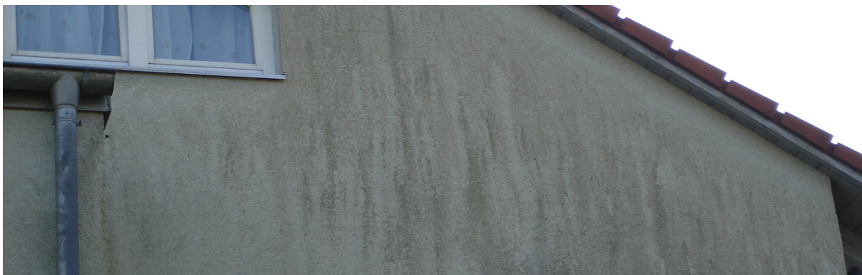
Algen und Pilze an einer Hausfassade Foto: © H. Bartholemy/ Bundesverband Farbe Gestaltung Bautenschutz
