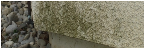
Algen und Pilze an einer Hausfassade
