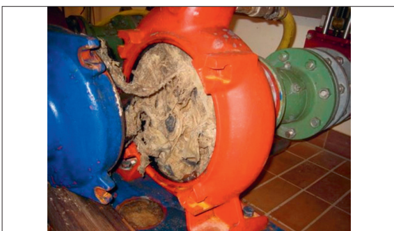
Durch Feuchttücher verstopfte Abwasserpumpe (Quelle: www.riedstadt.de – Abfall ABC)
