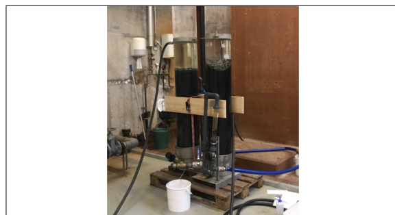
Installierte und betriebene Pilotanlage, befüllt mit fossile GAK und Pflanzenkohle. Eigene Darstellung
