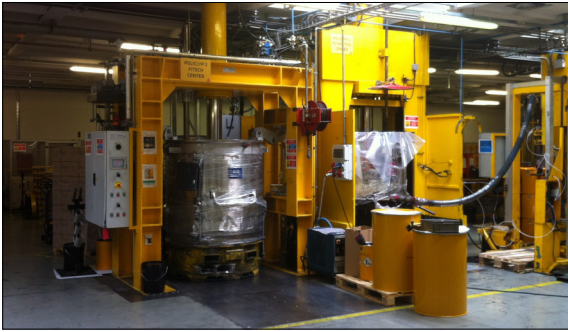
Abfüllstation bei der Firma SIKA AG
