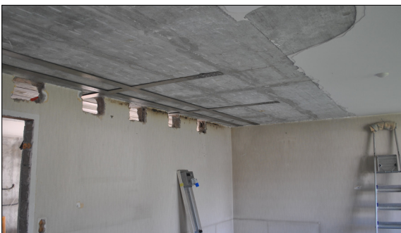
Verstärkung einer Stahlbetondecke in Brunner SZ mit den neuartigen SMA-Lamellen, [Quelle: Stefan Manz]
