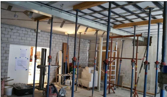
Ausgeführte Verstärkungsmassnahmen für die Decke der Zimmerei mit CFK und SMA-Lamellen [Quelle: Markus Keller, Bauherr]
