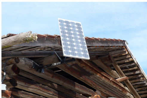
Bereits realisierte Photovoltaikanlage des Auftraggebers an einer anderen Berghütte
