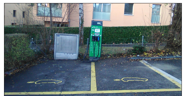
Verteilerkasten mit angeschlossener Ladestation Eigene Darstellung
