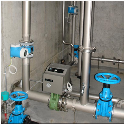
Rohrkeller Reservoir Alprüteli
