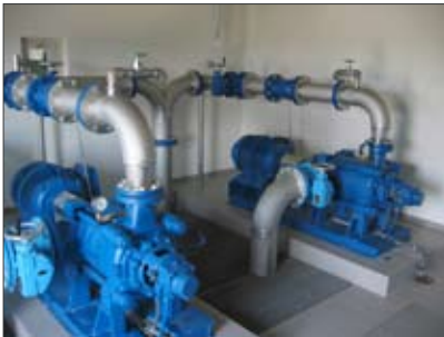
Bestehendes Pumpwerk Weier
