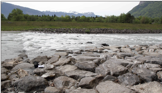
Stark beschädigte Schwelle im Alpenrhein beim Ellhorn. Wird gemäss Vorstudie durch ein Stützschwellenkraftwerk mit Obermeyerwehr ersetzt
