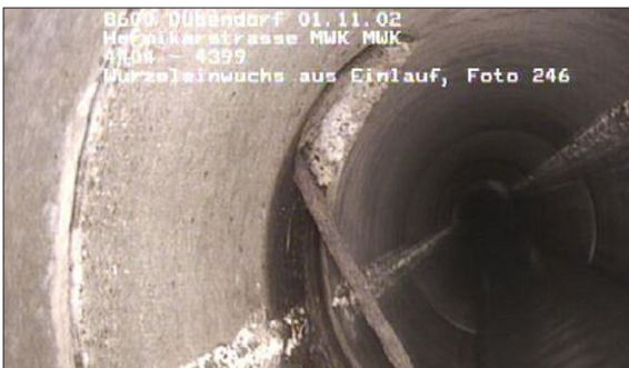
Kanal-TV diente zur Analyse des Leitungszustands.
