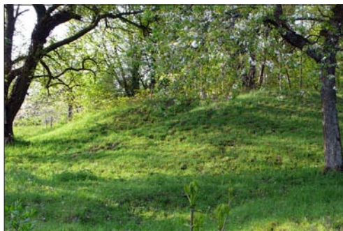
Der Damm des Müliweiher mit sichtbarer Erosion
