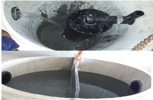
Oben: Adsorberkolonne in einem Rundschacht. Unten: Lamellenabscheider in einem Schlamm-sammler
