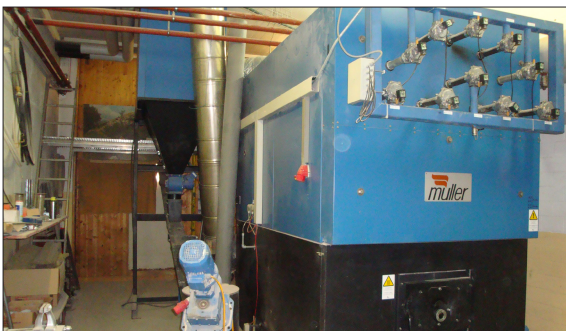
Holzschnittelofen mit 1000 kW Heizleistung
