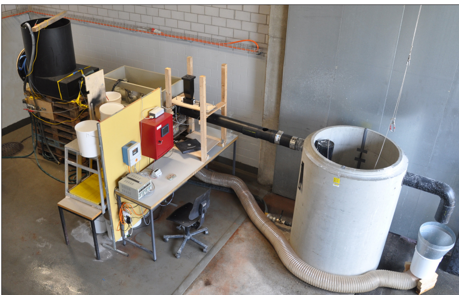
Gesamtanlage, bestehend aus Vorlagetank (links), Zulaufregelung, Dosieranlagen und Steuerung (Mitte) und Schlamm-sammler mit Lamellenklärer (rechts)
