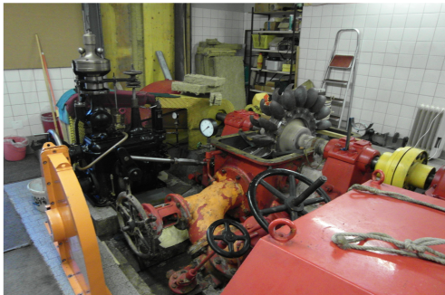
Die alte Peltonturbine des Kraftwerks Mühlehorn.
