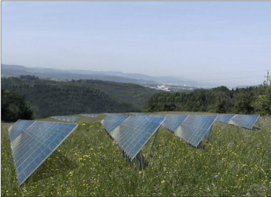
Feststehende Solaranlage im Gelände
