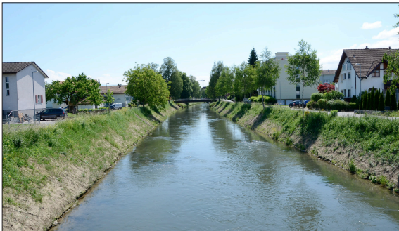
Aktueller Zustand: Der Flussraum ist nicht zugänglich und unattraktiv; die regelmässig abgeschürften Böschungen sind zu steil und sogar gefährlich.
