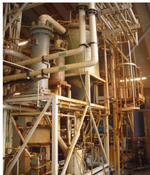
Grossanlage zum Ausfällen von Eisenchlorid
