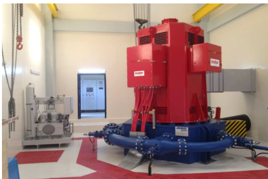
Maschinenhaus mit sechs-düsiger Pelton-Turbine und Synchrongenerator
