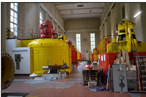
Maschinenraum in der Zentrale Rempen
