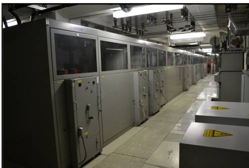
9.2-kV-Duplex-Schaltanlage in der Zentrale Rempen
