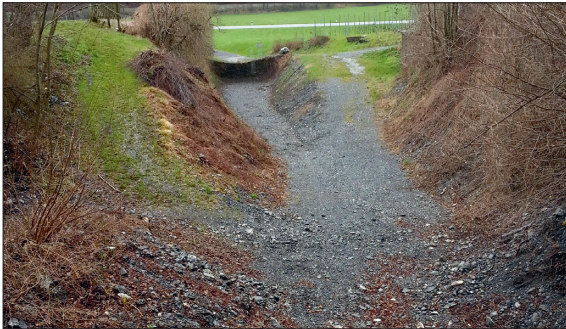
Bestehender Geschiebesammler mit einer Steinkorb Sperre
