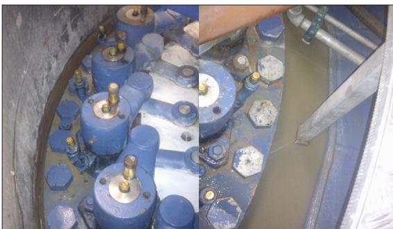
Leckage der Leitschaufelbüchsen, Aufnahme vom 28.3.2014
