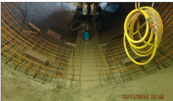
Beispiel-Problem Spritzbeton als massgebende Vortriebsgeschwindigkeit: Einbringen der Netze in 2. Lage, Bild SiSto Sachseln
